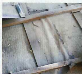
玄関への雨漏り原因箇所
