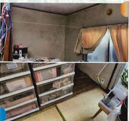
リビングの箆置き場の壁と床は、 だいぶ湿気で傷みが出ていました
