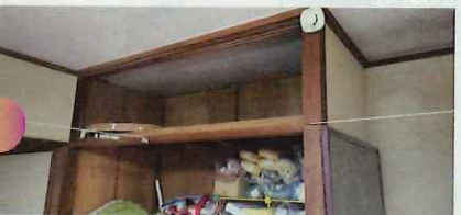
箆置き場の隣の押し入れ。 結露・カビが大変だったとのこと
