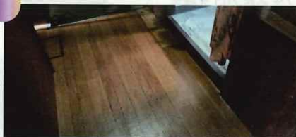
廊下の隅々が経年と湿気で 傷んでいました。 壁も床も色が濃い内装でした。
