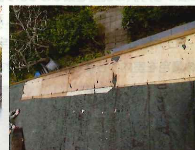
屋根材をはがすと、雨漏りが見つかりました
