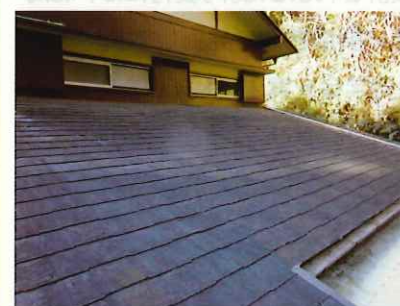
スレート屋根材にだいぶひびが入ってきました
