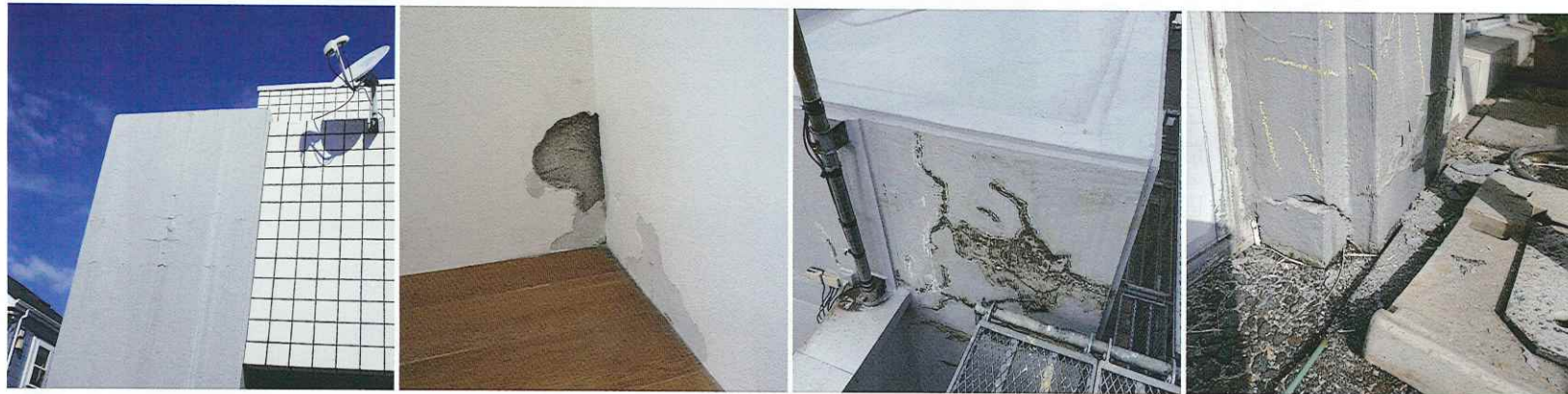
●コンクリート塗装の塗膜剥がれ ●室内階段踊り場の雨漏り ●陸屋根側面のコンクリートの亀裂 ●地面近くのコンクリートの亀裂
