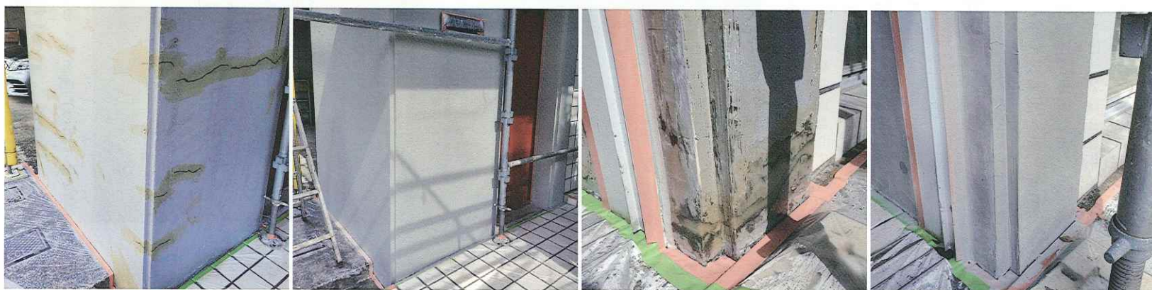
● 駐車場出入口の亀裂補修 ● 亀裂補修後の下塗り ● 地面近くのコンクリートの亀裂補修 ● 亀裂補修後の下塗り
