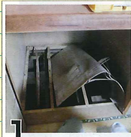
1 床板は経年変化と湿気でボロボロ状態
