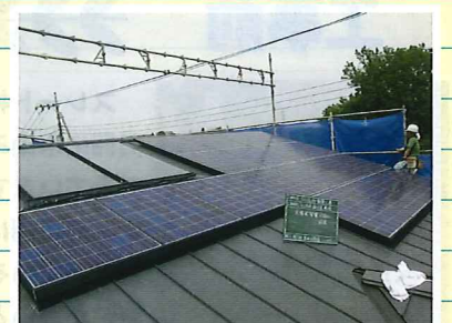
新築時に屋根に載せた太陽熱集熱パネルと太陽光発電3.04kW
