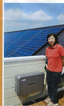
屋根バルコニーから太陽光発電を間近に見られるM邸
