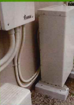
🔋 蓄電池ユニット ：7.04kWh
