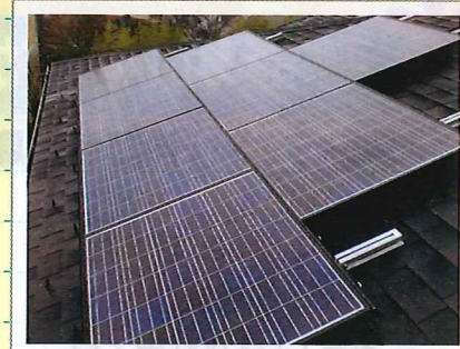
WCAの特別融資で4kWの太陽光発電を設置した鎌倉市T邸
