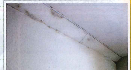
黒カビが発生したマンション北側の部屋
