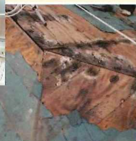
屋根材を剥がすと防水シートがありその下の野地板が腐っていました。
