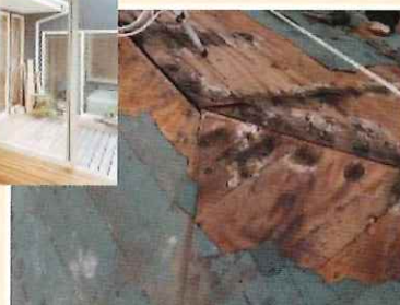
屋根材を剥がすと防水シートがありその下の野地板が腐っていました。
